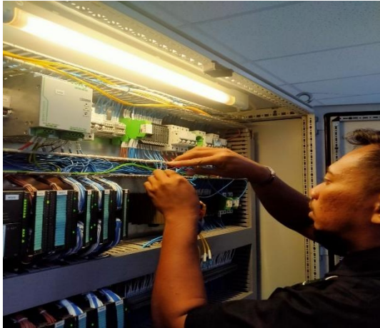
Perbaikan Control Desk Yang Error
