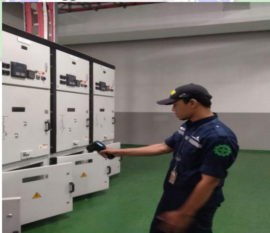
Pengecekan Rutinan Suhu Tranformator
