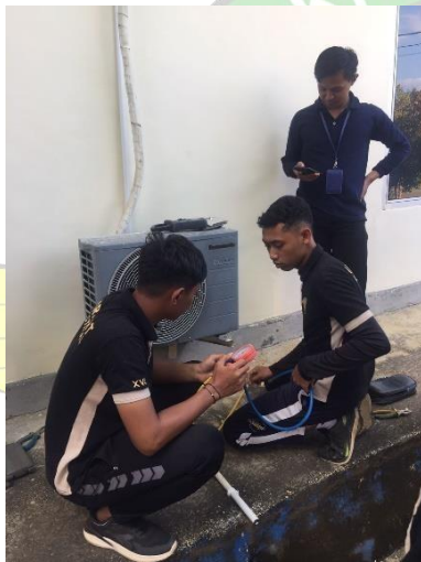
Perawatan AC Kantor
