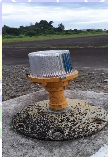
Gambar 2. 25 Elevated Threshold Light Sumber : Dokumentasi Penulis
