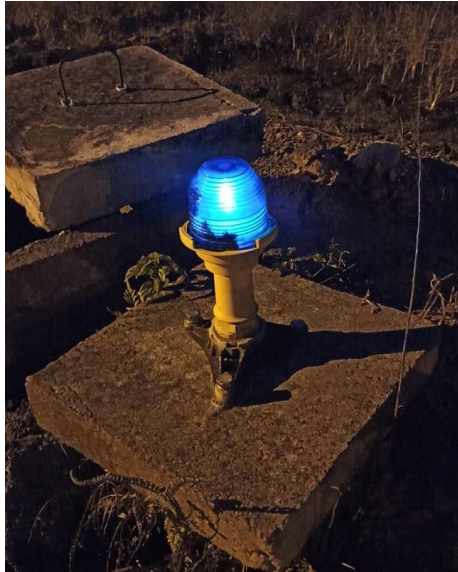
Gambar 2. 29 Taxiway Edge Light Sumber : Dokumentasi Penulis
