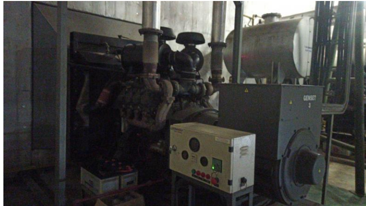
Gambar 2. 19 Genset 3 Sumber : Dokumentasi Penulis
