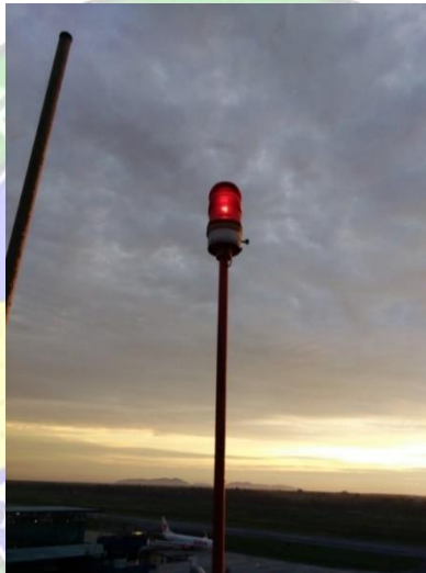
Gambar 2. 32 Obstruction Light Sumber : Dokumentasi Penulis
