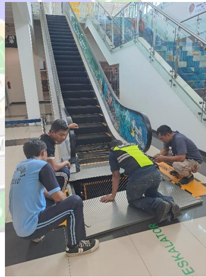
Mengecek Kerusakan Pada Eskalator
