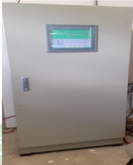
Gambar 2. 34 Control Desk Sumber : Dokumentasi Penulis
