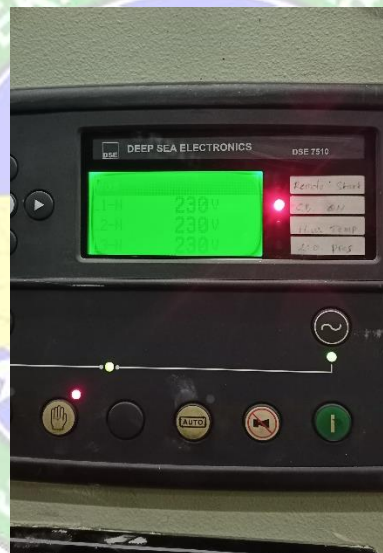
Gambar 4. 17 Indikator V_{L\sim N} Sumber : Dokumentasi Penulis
