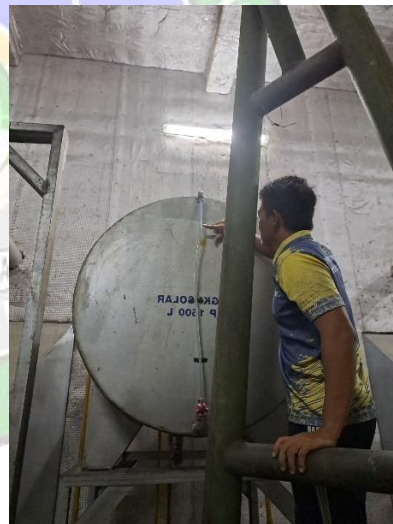
Memeriksa Tangki Bahan Bakar Genset
