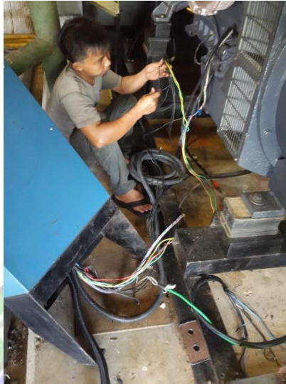
Gambar 4. 3 Memeriksa Kabel-kabel keluaran genset Sumber : Dokumentasi Penulis
