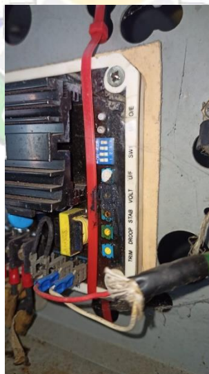
Gambar 4. 4 Memeriksa kerusakan AVR secara visual Sumber : Dokumentasi Penulis
