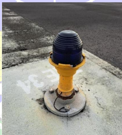
Gambar 2. 12 Taxiway Edge Light Sumber : Dokumentasi penulis
