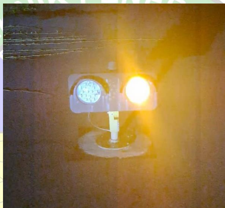
Gambar 2. 13 Runway Guard Light Sumber : Dokumentasi penulis
