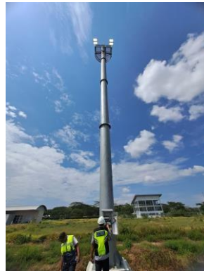
Gambar 2. 18 Flood Light Sumber : Dokumentasi penulis
