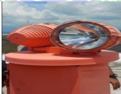
Gambar 2. 17 Rotating Beacon Sumber : Dokumentasi penulis
