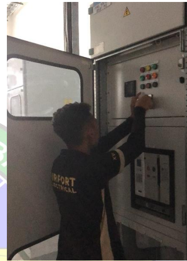
Perawatan dan Pengecekan ATS
