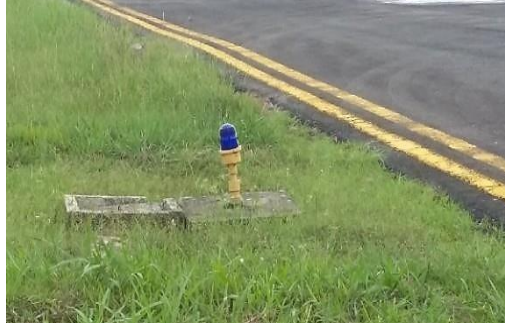
Gambar 2.12 Apron Light Sumber: Bandar Udara Internasional Syamsudin Noor
