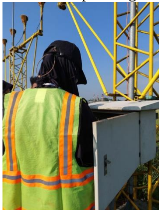
Perawatan approach light dan SQFL beserta trafo seri
