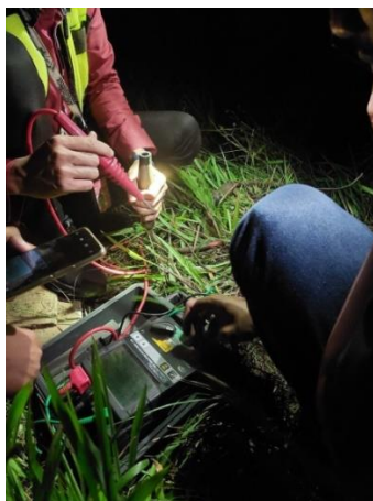
Pengukuran tahanan isolasi Runway Edge Light circuit 1
