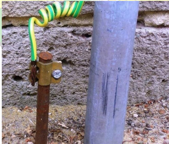
Gambar 3. 11 Arde dan grounding
