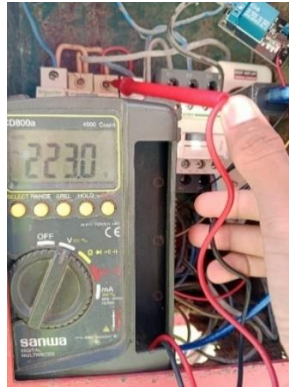
Gambar 4. 31 Pengukuran Tegangan Lampu 1
