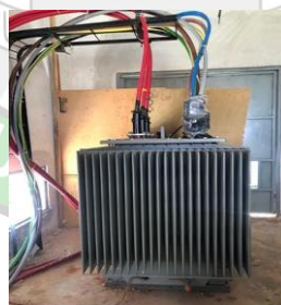
Gambar 4. 4 Trafo Step Down
