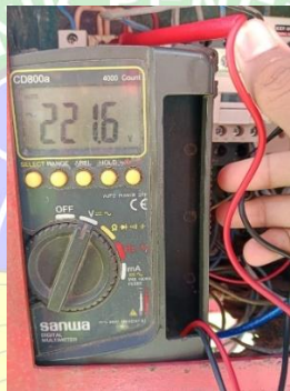
Gambar 4. 32 Pengukuran tegangan lampu 2
