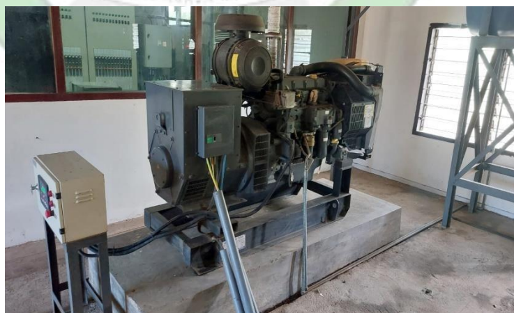
Gambar 4. 2 Genset Jerbindo 100 KVA
