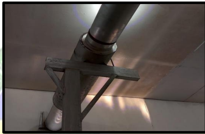
Gambar 3. 6 Exhaust Cooling System Sumber : Dokumentasi Pribadi
