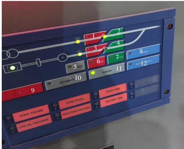
Gambar 4. 8 Monitor Panel AMF Sumber : Dokumen Pribadi
