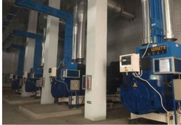
Gambar 2. 31 Genset 2000 KVA Sumber: Dokumentasi penulis
