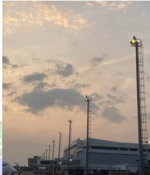
Gambar 2. 24 Apron Flood Light Sumber: Dokumentasi penulis
