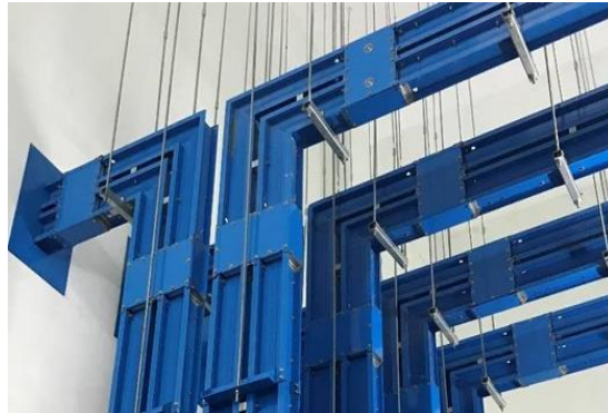
Gambar 2. 42 Busduct Sumber: Dokumentasi penulis
