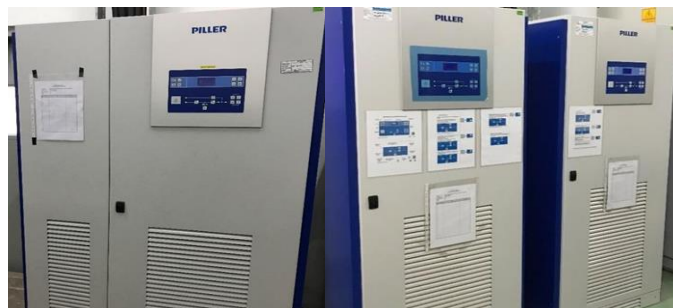
Gambar 2. 37 Uninterreptible Power Supply Sumber: Dokumentasi penulis
