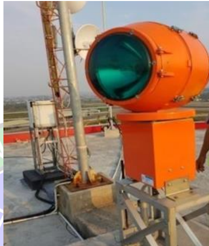
Gambar 2. 18 Rotating Beacon Sumber: Dokumentasi penulis
