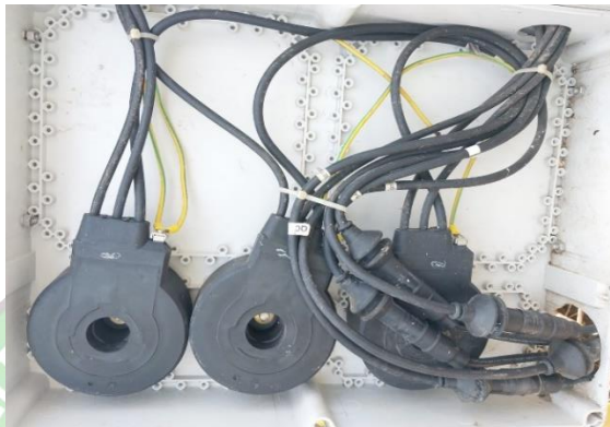
Gambar 3. 15 Trafo Series Sumber: Dokumentasi penulis
