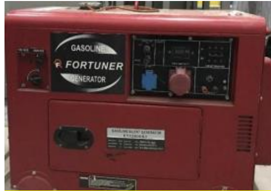
Gambar 2. 35 Genset 10 KVA Sumber: Dokumentasi penulis
