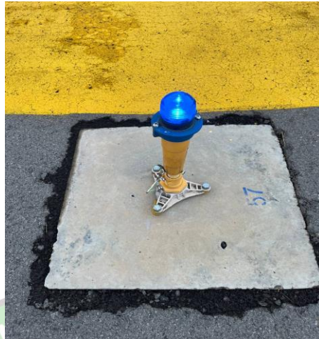
Gambar 2. 15 Taxiway Edge Light Sumber: Dokumentasi penulis
