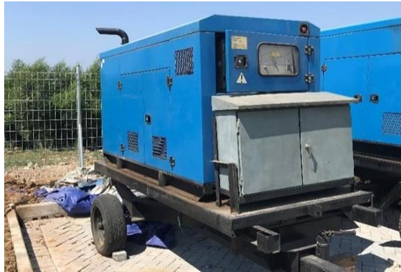
Gambar 2. 34 Genset 60 KVA Sumber: Dokumentasi penulis
