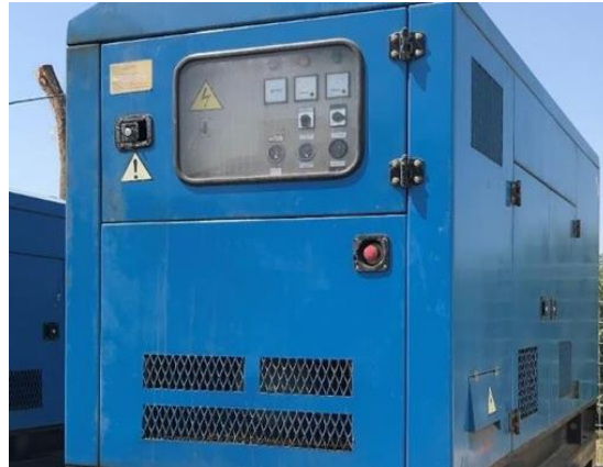
Gambar 2. 33 Genset 160 KVA Sumber: Dafas Semarang update 2020
