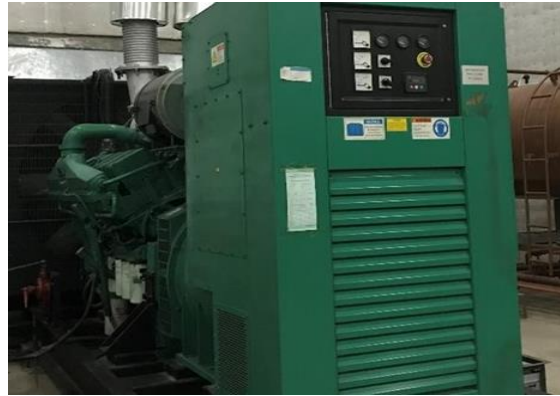
Gambar 2. 32 Genset 1000 KVA Sumber: Dafas Semarang update 2020
