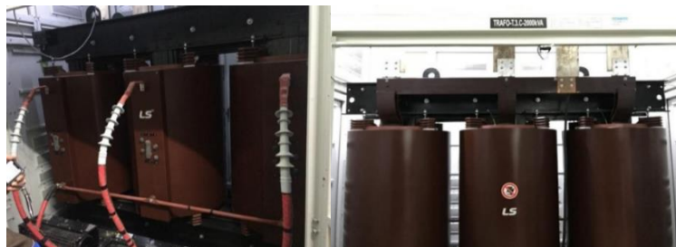
Gambar 2. 38 Transformator Step Down Sumber: Dokumentasi penulis
