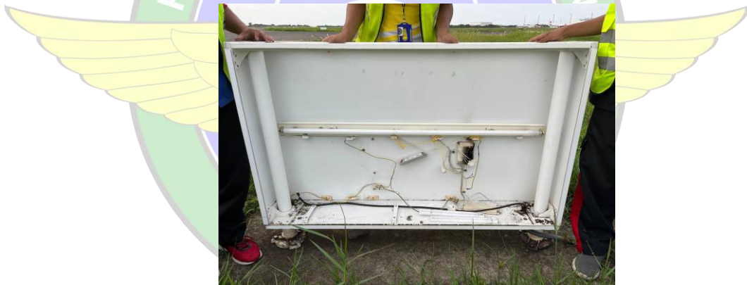
Gambar 4. 2 Pemeriksaan Taxiway Guidance Sign Foxtrot Sumber: Dokumentasi penulis
