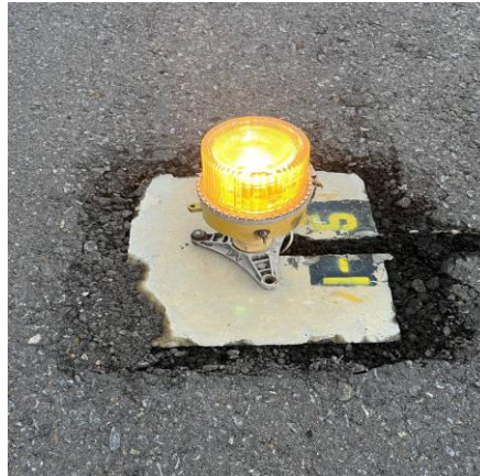
Gambar 2. 3 Runway Edge Light Sumber: Dokumen Penulis
