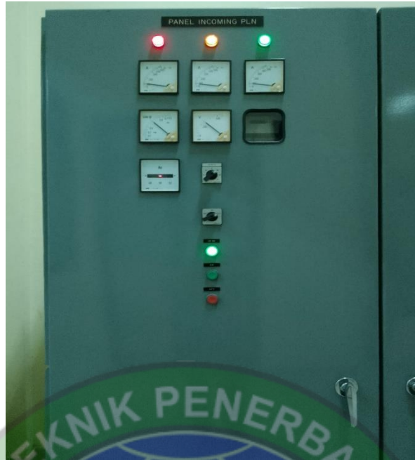
Gambar 3. 5 Panel Incoming PLN Sumber : Dokumentasi Lapangan
