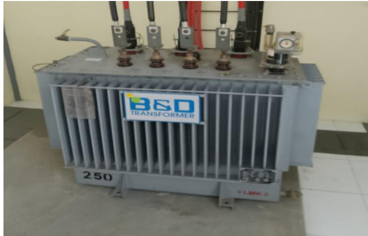
Gambar 2. 4 Transformator Sumber : Dokumentasi Lapangan
