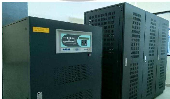
Gambar 2. 5 Uninterruptible Power Supply Sumber : Dokumentasi Lapangan
