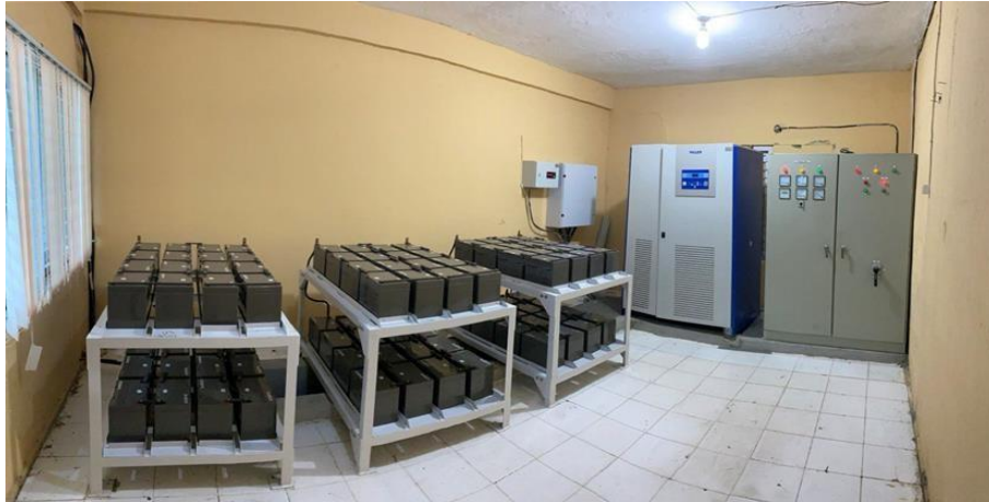
Gambar 4.8 UPS Piller 160 Kva
