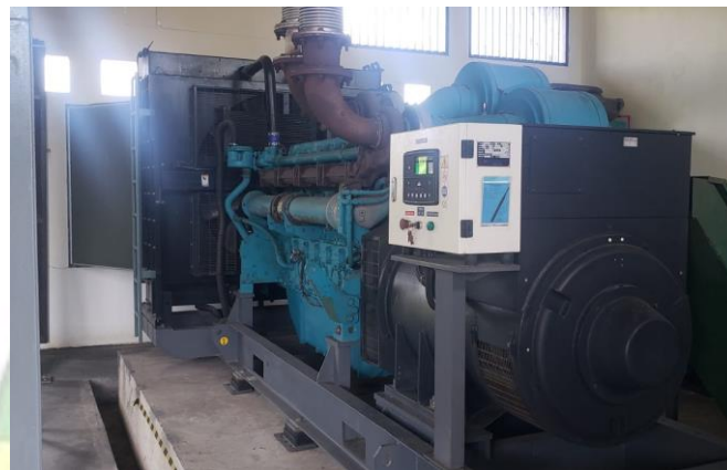
Gambar 2. 4 Genset 1000 KVA di PH Baru Sumber : Bandara Internasional Juwata Tarakan
