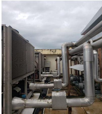
Gambar 2. 37 3 Unit Chiller Sumber : Bandara Internasional Juwata Tarakan
