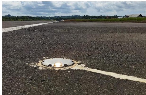
Gambar 2. 17 Runway Edge Light Inset Sumber : Bandara Internasional Juwata Tarakan
