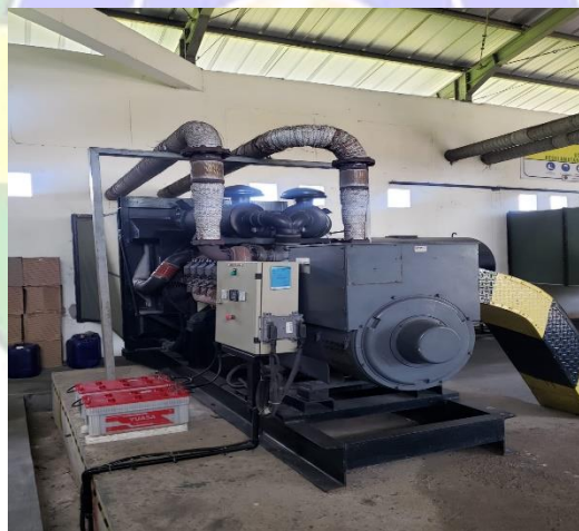
Gambar 2. 6 Genset 500 KVA di PH Baru Sumber : Bandara Internasional Juwata Tarakan
