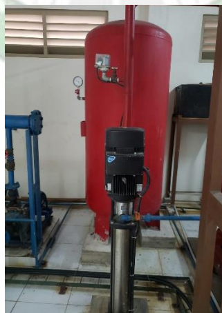
Gambar 2. 31 Pompa Joki Hydrant Sumber : Bandara Internasional Juwata Tarakan
