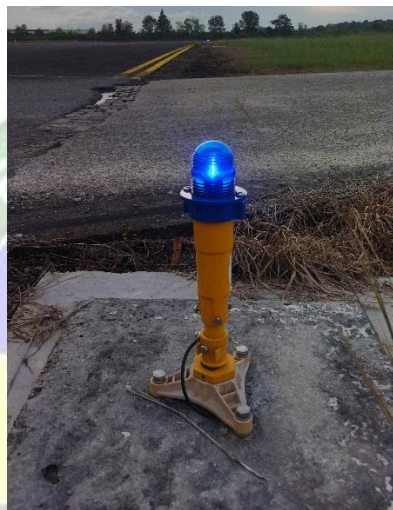
Gambar 2. 18 Taxiway Edge Light Sumber : Bandara Internasional Juwata Tarakan
