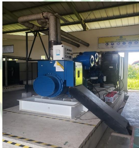
Gambar 2. 5 Genset 1000 KVA di PH Baru Sumber : Bandara Internasional Juwata Tarakan
