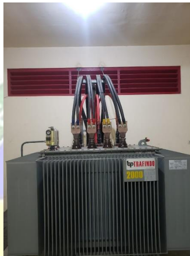
Gambar 2. 12 Trafo Step Down 2000 KVA Sumber : Bandara Internasional Juwata Tarakan
