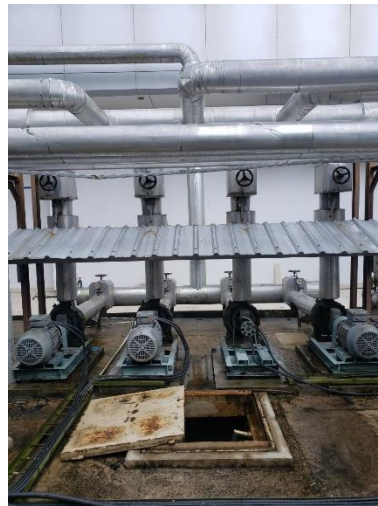
Gambar 2. 33 Pompa Chiller Sumber : Bandara Internasional Juwata Tarakan
