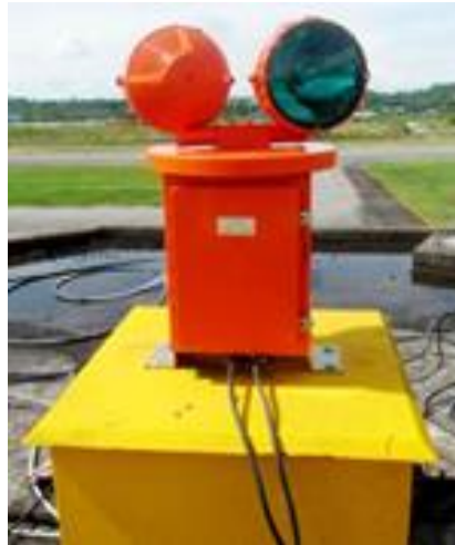
Gambar 2. 20 Rotating Beacon Sumber : Bandara Internasional Juwata Tarakan
