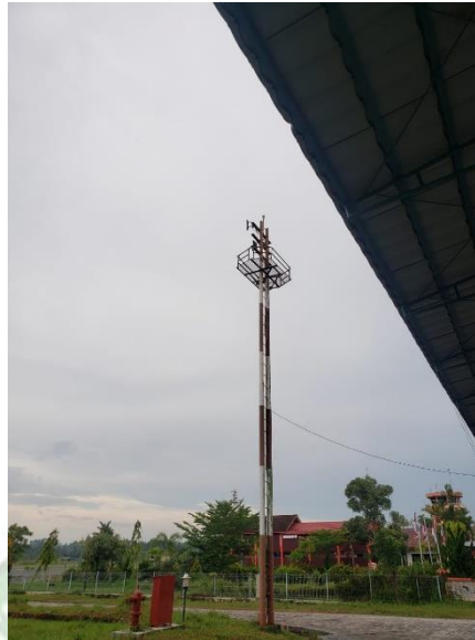
Gambar 2. 24 Flood Light Tiang Ganda Sumber : Bandara Internasional Juwata Tarakan
