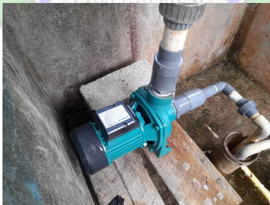
Gambar 2. 36 Pompa Shimge Sumber : Bandara Internasional Juwata Tarakan
