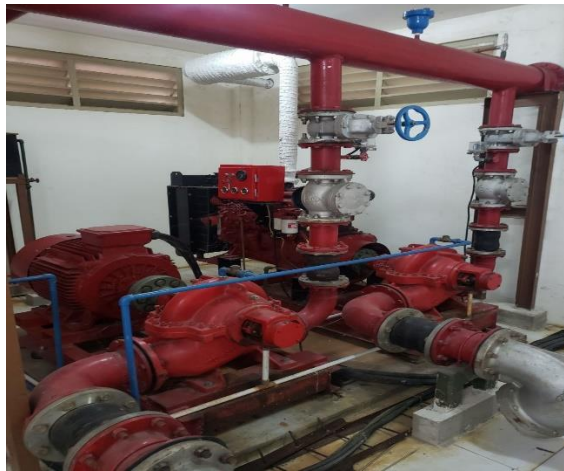
Gambar 2. 30 Pompa Hydrant Sumber : Bandara Internasional Juwata Tarakan
