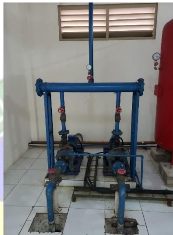
Gambar 2. 32 Pompa Transfer Sumber : Bandara Internasional Juwata Tarakan
