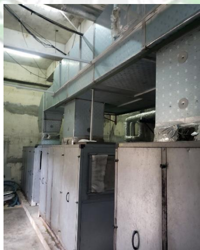
Gambar 2. 39 AHU 50 PK Sumber : Bandara Internasional Juwata Tarakan
