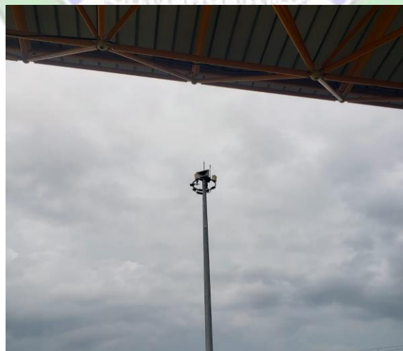
Gambar 2. 23 Flood Light Tiang Tunggal Sumber : Bandara Internasional Juwata Tarakan
