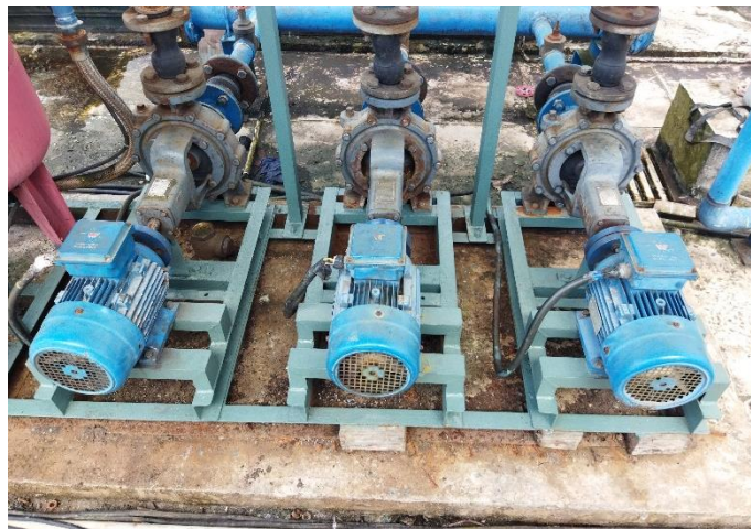
Gambar 2. 34 Pompa Booster Sumber : Bandara Internasional Juwata Tarakan
