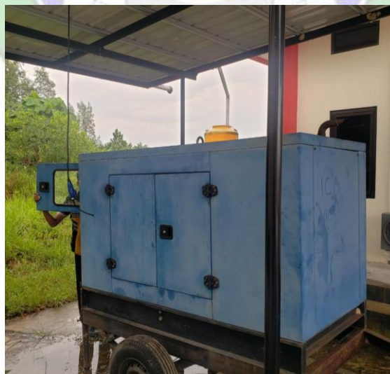
Gambar 2. 7 Genset Mobile 25 KVA Sumber : Bandara Internasional Juwata Tarakan
