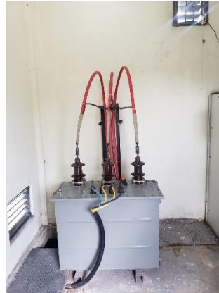
Gambar 2. 13 Trafo Step Down 50 KVA Sumber : Bandara Internasional Juwata Tarakan
