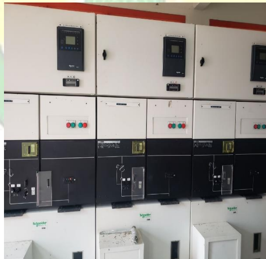
Gambar 2. 11 Cubicle Incoming TM Sumber : Bandara Internasional Juwata Tarakan
