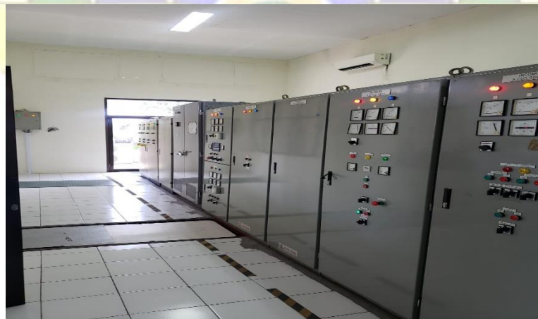
Gambar 2. 15 Panel Utama (ACOS, Transmisi, dan Distribusi) di PH Baru Sumber : Bandara Internasional Juwata Tarakan
