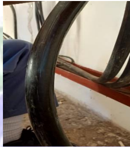
Gambar 2.10 Kabel NYYY pada distribusi ke panel pompa hydrant
