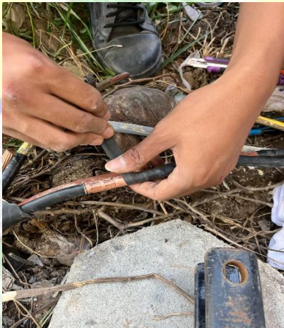
Gambar 4.7 Merubber dan isolasi pada kabel
