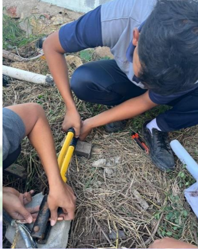
Gambar 4.6 Mengkrempling pada sambungan kabel
