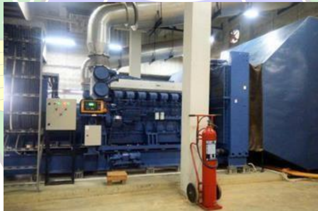
Gambar 2. 6 Generator set 2 x 2200 Kva Sumber : UPBU A.P.T. Pranoto Samarinda
