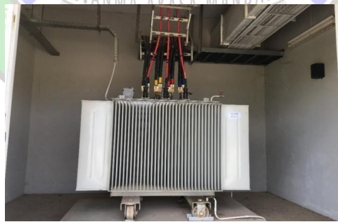
Gambar 2. 8 Trafo PTR Sumber : UPBU A.P.T. Pranoto Samarinda
