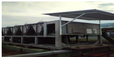
Gambar 2. 18 Chiller Sumber : UPBU A.P.T. Pranoto Samarind
