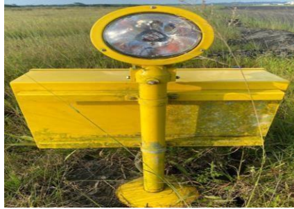
Gambar 2. 28 Kontruksi RTIL Sumber : UPBU A.P.T. Pranoto Samarinda
