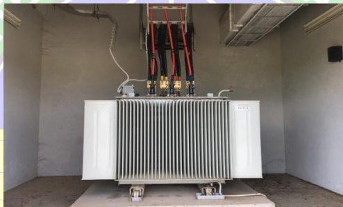
Gambar 2. 7 Trafo Step Up Sumber : UPBU A.P.T. Pranoto Samarinda
