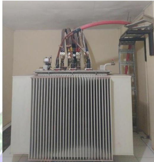
Gambar 2. 9 Trafo Step Up 1250 kVA
