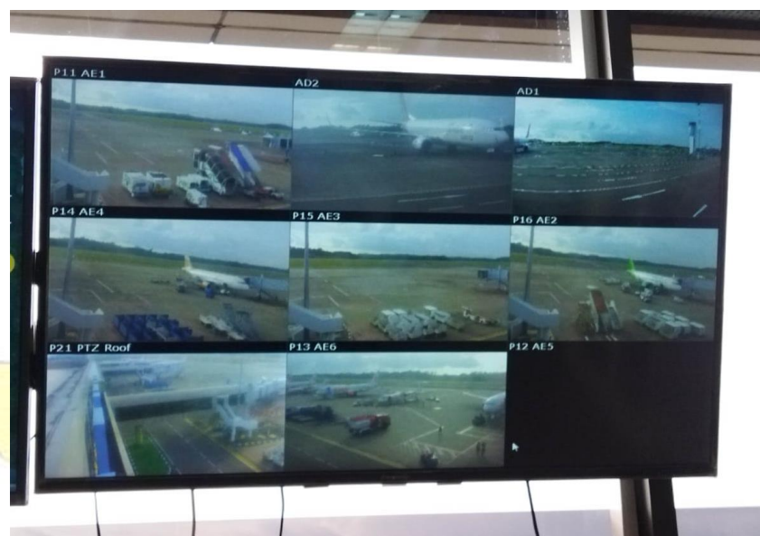
Gambar 4. 7 Monitor CCTV unit AMC (Sumber: Dokumentasi penulis)
