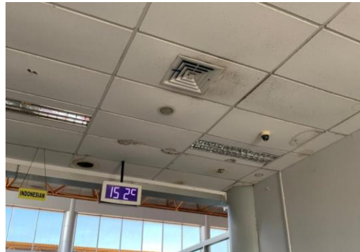
Gambar 3.7 Fasilitas Terminal yang Rusak
