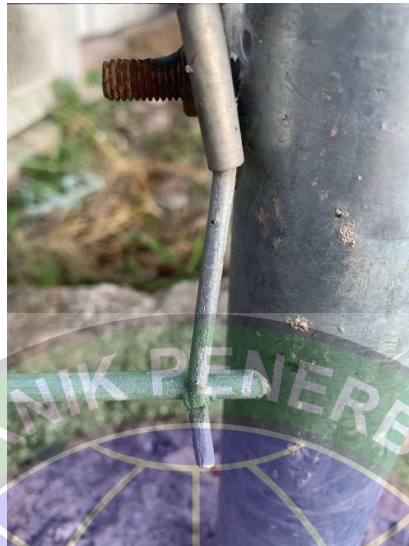
Gambar 4.17 Baut dan mur pagar perimeter yang berkarat
