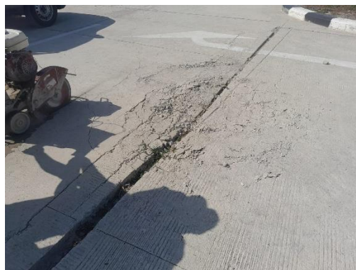
Gambar 4. 14 Kerusakan Jalan Akses (Sumber: Olahan Penulis, Tahun 2023)
