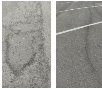
Gambar 4. 59 Dokumentasi Kerusakan (Sumber: Dokumentasi Penulis, Tahun 2023)
