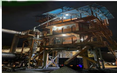
Gambar 4. 38 Asphalt Mixing Plant (Sumber: Dokumentasi Penulis, Tahun 2023)
