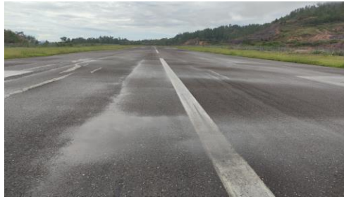
Gambar 4. 39 Depression STA 0+450 (Sumber: Dokumentasi Penulis, Tahun 2024)
