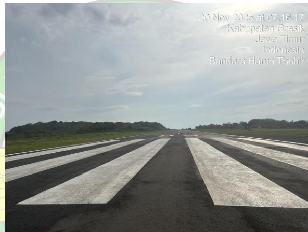
Gambar 4. 4 Kondisi Marka yang telah Memudar
