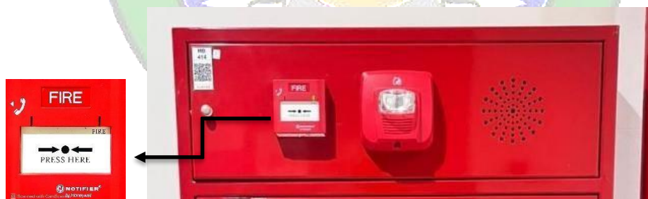
Gambar 3 5 Fire Alarm Sumber: Dokumentasi Penulis 2026
