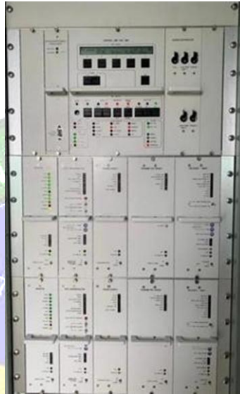
Gambar 3. 12 Transmitter DME Merk Interscan Sumber: Dokumentasi Penulis 2025
