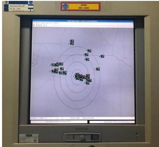
Gambar 3. 14 Display ADSB di Equipment Room Sumber: Dokumentasi Penulis 2025
