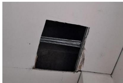
Gambar 4. 16 Dokumentasi Kerusakan Plafon
