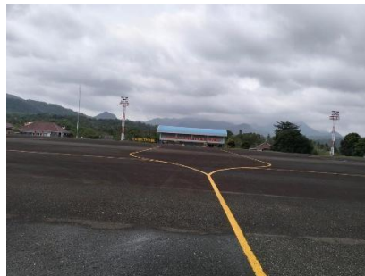
Gambar 4. 8 Marka apron saat terjadi pemudaran
