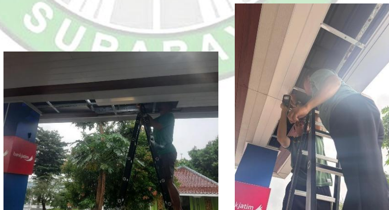
Gambar 4. 14 Pencarian Titik Kebocoran Pada Atap Terminal
