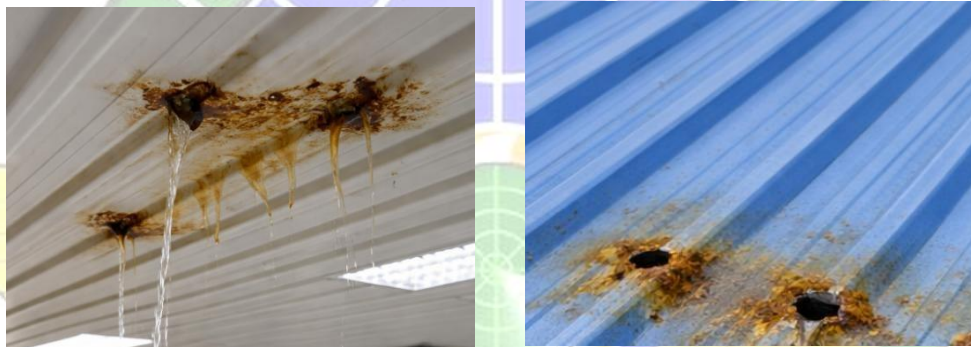
Gambar 4. 9 Kondisi atap Gedung terminal saat terjadi kebocoran
