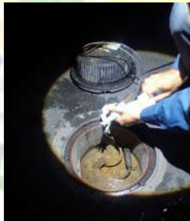
Gambar 4. 8 Memberikan Isolasi Pada Konektor LampuRunway Edge Inset
