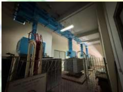
Gambar 2. 14 Trafo Genset Terminal 2
