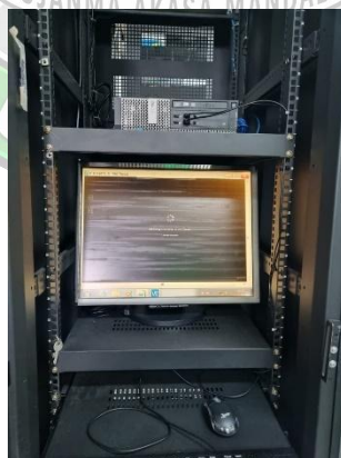
Gambar 3.11 5 Melakukan Restart Server ATIS di Ruangan ARO Sumber : Dokumentasi Penulis 2025
