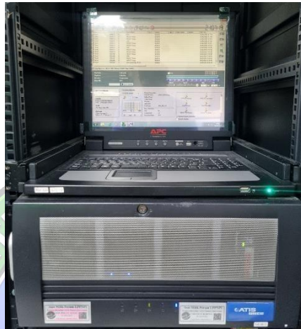
Gambar 3.2 4 Server Recorder Sumber : Dokumentasi Penulis 2025
