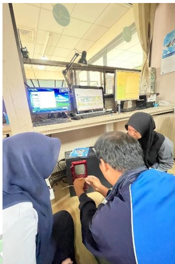
Gambar 3.11 2 Memeriksa kondisi kabel UTP & Konektor RJ45 Sumber: Dokumentasi Penulis 2025
