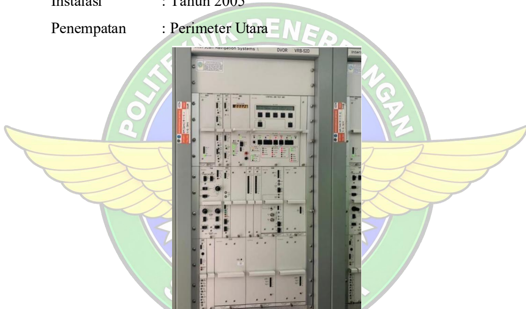
Gambar 3.3 1 Transmitter DVOR Merk InterScan Sumber : Dokumentasi Penulis 2025
