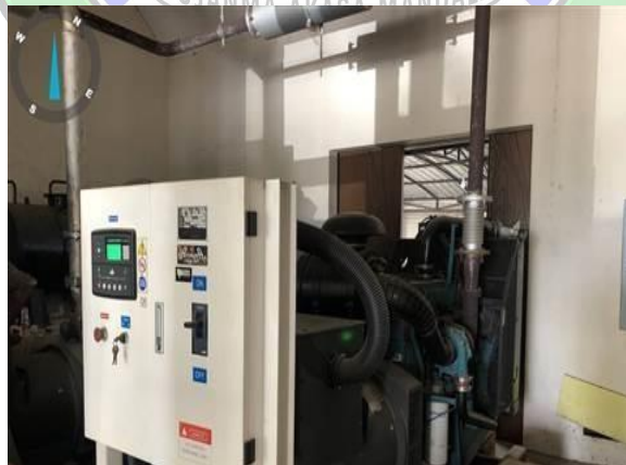
Gambar 3.1.5 19 Genset 250KVA Sumber : Dokumentasi Penulis 2026
