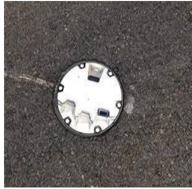
Gambar 3.1.5 4 Runway Edge Insert Light Sumber : Dokumentasi Penulis 2026
