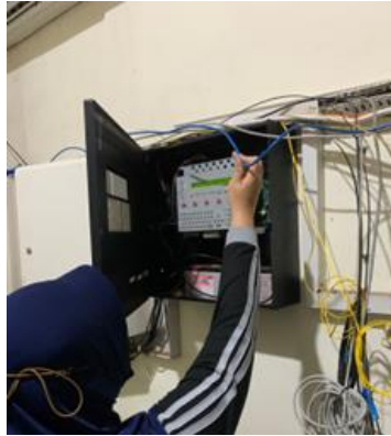
Gambar 3.1.2 3 Panel Kontrol Fire Alarm Sumber : Dokumentasi Penulis 2026
