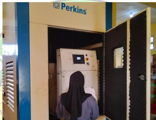
Gambar 3.1.5 18 Genset 500KVA Merk PERKINS Sumber : Dokumentasi Penulis 2026
