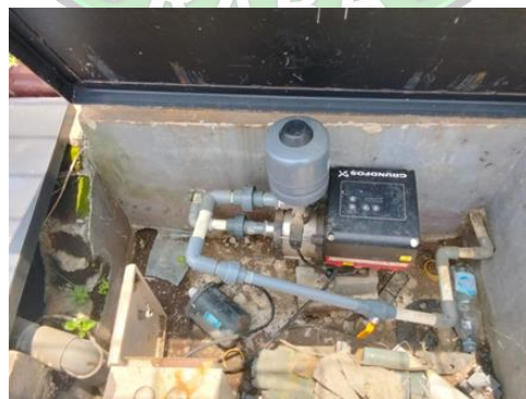
Gambar 3.1.4 4 Pompa Sentrifugal Sumber : Dokumentasi Penulis 2026
