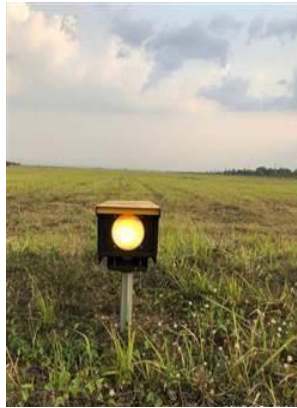
Gambar 3.1.5 2 Lampu PAPI Sumber : Dokumentasi Penulis 2026
