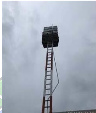
Gambar 3.1.5 8 Flood Light Sumber : Dokumentasi Penulis 2026
