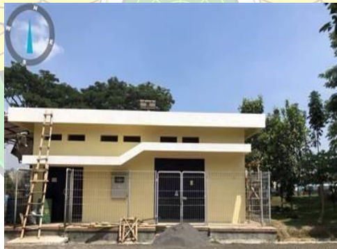
Gambar 3.1.3 12 Bangunan Trafo Sumber : Dokumentasi Penulis 2026
