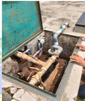
Gambar 3.4.6 1 Pompa Otomatis Sumber : Dokumentasi Penulis 2026
