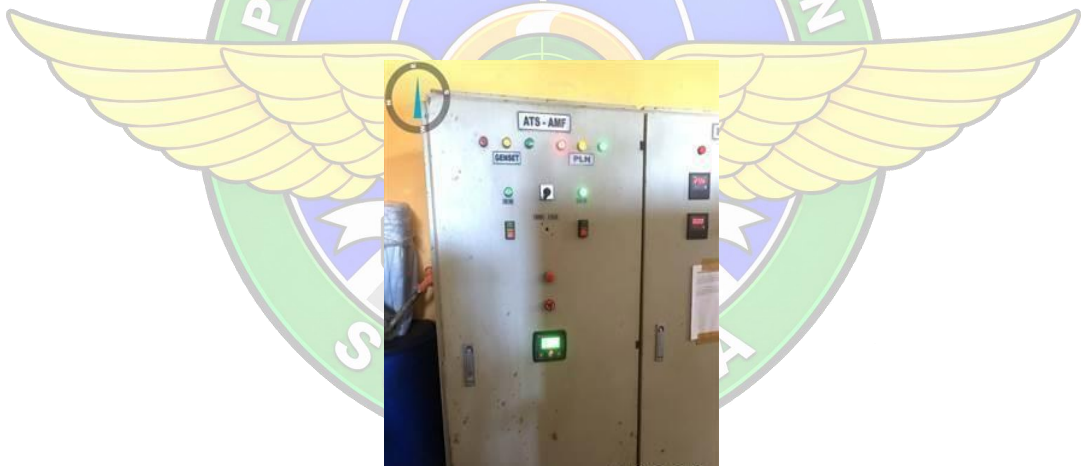
Gambar 3.1.5 21 Panel ACOS Sumber : Dokumentasi Penulis 2026
