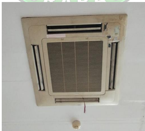
Gambar 3.1.4 3 AC Cassette Sumber : Dokumentasi Penulis 2026
