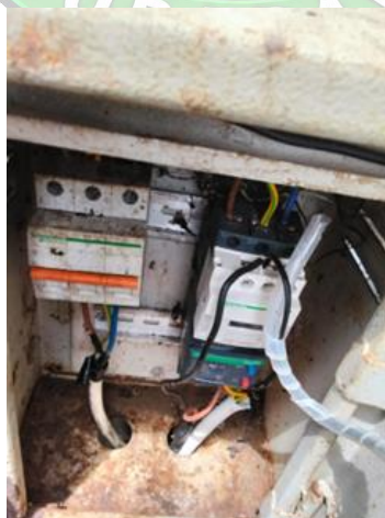
Gambar 3.4.11 1 Panel Kontrol Pompa Otomatis Sumber : Dokumentasi Penulis 2026
