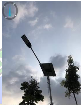
Gambar 3.1.5 17 Solar Cell Sumber : Dokumentasi Penulis 2026
