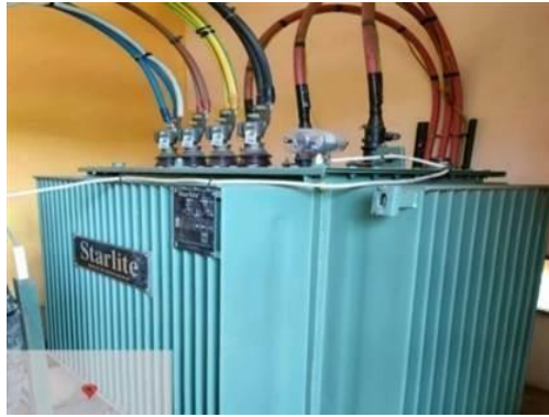
Gambar 3.1.5 14 Trafo Step Down Sumber : Dokumentasi Penulis 2026
