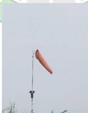
Gambar 3.1.5 9 Wind Direction Indicator Sumber : Dokumentasi Penulis 2026
