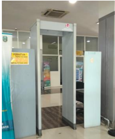
Gambar 3.4.1 1 WTMD Merk CEIA Sumber : Dokumentasi Penulis 2026
