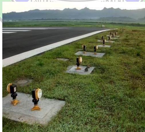
Gambar 3.1.5 5 Thershold Light Elevated Sumber : Dokumentasi Penulis 2026
