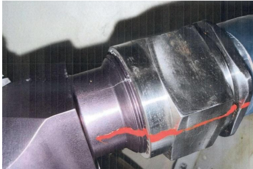
Gambar 3. 7 Crack pada outlet discharge
