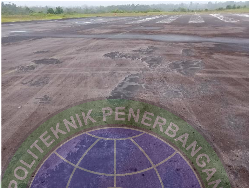
C.1 Keluarnya material aspal ke permukaan ( Bleeding )
