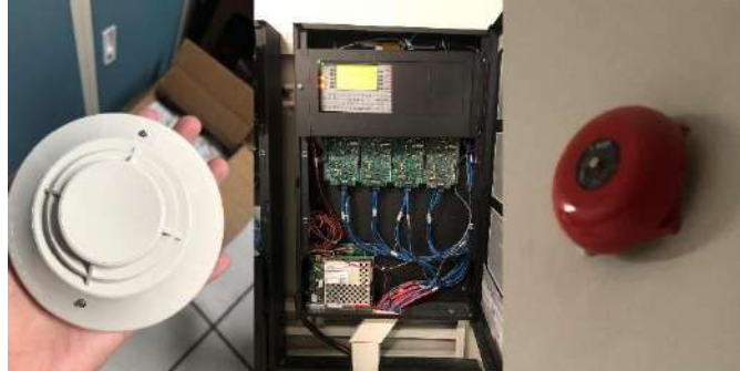
Gambar 3.11 Fire Alarm Sumber : Dokumentasi Pribadi, 2025
