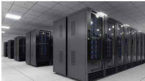
Gambar 3. 10 Contoh ruangan Server (Sumber : www.masterdc.com )
