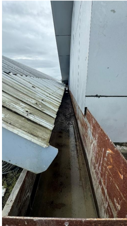
Gambar 4.37 Kondisi Talang Air Baja Ringan Terminal Lama
