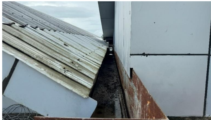
Gambar 4.34 Kondisi Talang Air Baja Ringan Terminal Lama
