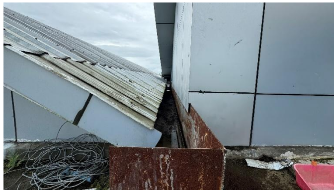
Gambar 4.35 Kondisi Talang Air Baja Ringan Terminal Lama
