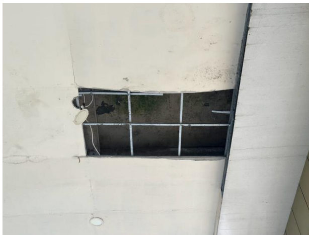
Gambar 4. 13 Lubang pada plafond terminal
