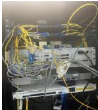
Gambar 4.2 Multiplexer Di ruang TX
