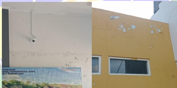
Gambar 4. 16 Tembok Yang Rusak Sumber : Olahan Penulis, 2024
