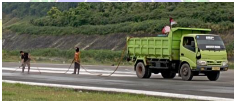
Gambar 4. 25 Mobile Compressor (Sumber : Dokumentasi Pribadi, 2024)
