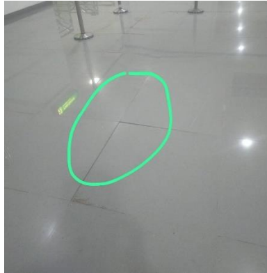
Gambar 4.14 Kondisi lantai di terminal yang terangkat
