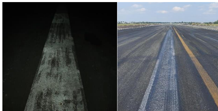
Gambar 4.13 Kondisi marka runway yang pudar
