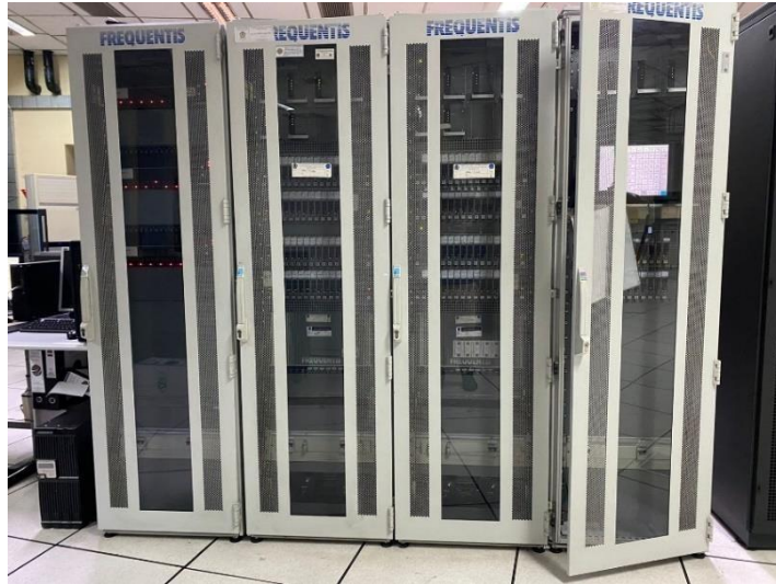
Gambar3 .9 Cabinet VCCS – FREQUENTIS di Gedung MER Sumber : Dokumentasi Penulis 2024
