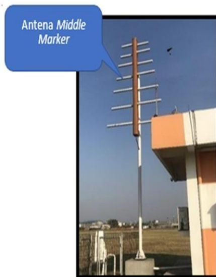
Gambar 3.17 Antena Middle Marker Sumber : Perum LPPNPI Cabang JATSC, 2024
