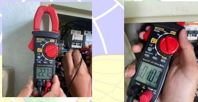
Gambar 3.43 Melakukan pengecekan Tegangan dan Arus
