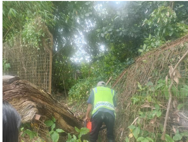
Gambar 4. 10 Kondisi Pagar Parimeter yang tertimbun pohon (Sumber: Olahan penulis,2025)
