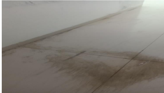
Gambar 4. 18 Terdapat kebocoran yang menetes di lantai area terminal
