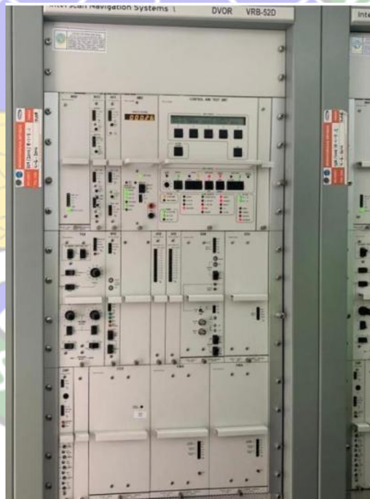
Gambar 3. 11Transmitter DVOR Merk Interscan Sumber: Dokumentasi Penulis
