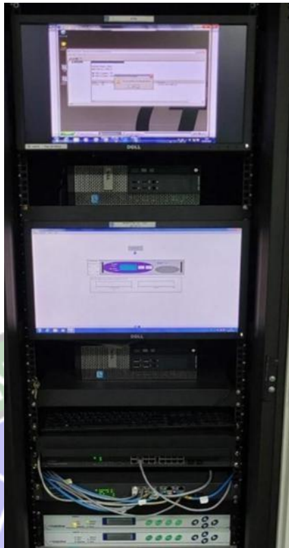
Gambar 3. 6 Reproducer ATIS Merk TERMA Sumber: Dokumentasi Penulis
