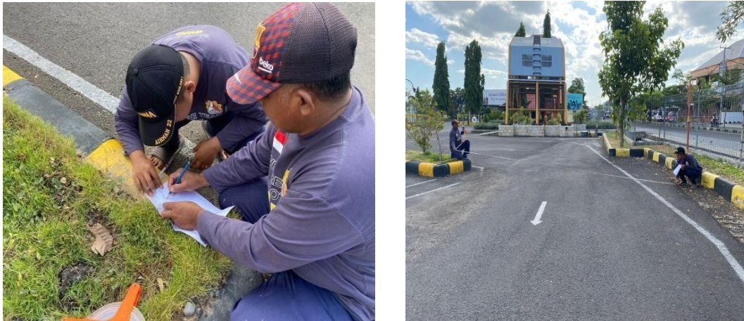
Gambar 4. 12 Pengecekan lokasi dan Pengukuran Marka Parkir
