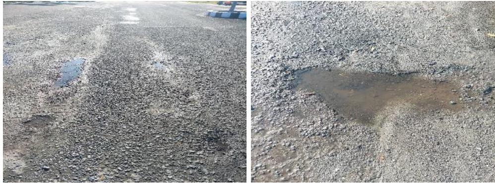
Gambar 4. 16 Kerusakan Jalan Akses Sisi Darat Sumber : Dokumentasi Pribadi, Tahun 2024
