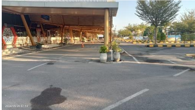
Gambar 4.14 Permukaan Drop Zone yang terkikih ( Sumber : Dokumentasi Pribadi, 2024 )
