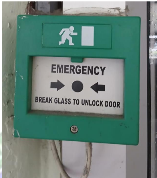
Gambar 3. 23 Emergency Break Glass Sumber: Dokumentasi Penulis 2025
