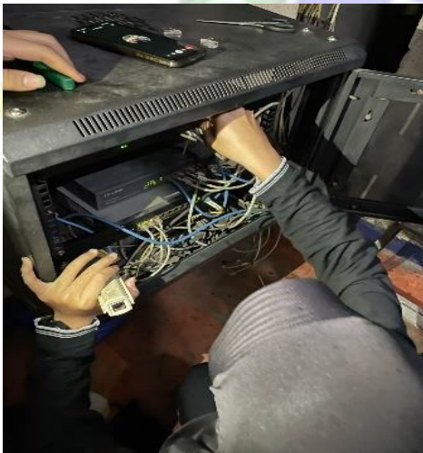
Pengecekan Kabel LAN
