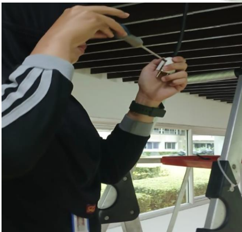
Perbaikan stop kontak pada slave clock
