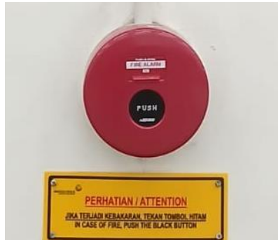
Gambar 3. 17 Fire Alarm Bell Sumber: Dokumentasi Penulis, 04 Februari 2025
