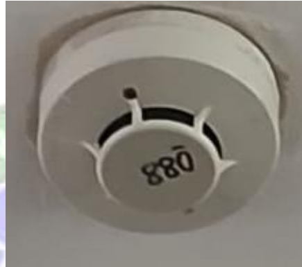
Gambar 3. 19 Smoke Detector Sumber: Dokumentasi Penulis, 31 Januari 2025
