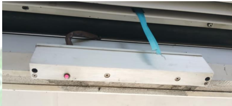
Gambar 3. 22 Magnetic Lock Sumber: Dokumentasi Penulis 2025
