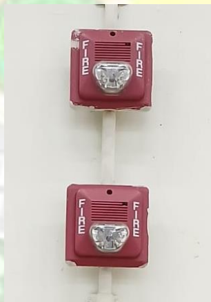
Gambar 3. 18 Fire Alarm Lamp Sumber: Dokumentasi Penulis, 04 Februari 2025
