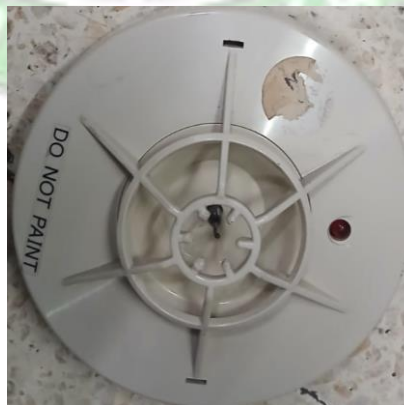
Gambar 3. 20 Fixed Temperature Heat Detector Sumber: Dokumentasi Penulis, 31 Januari 2025
