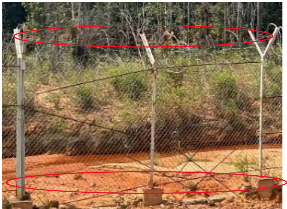
Gambar 4. 6 Pagar perimeter rusak
