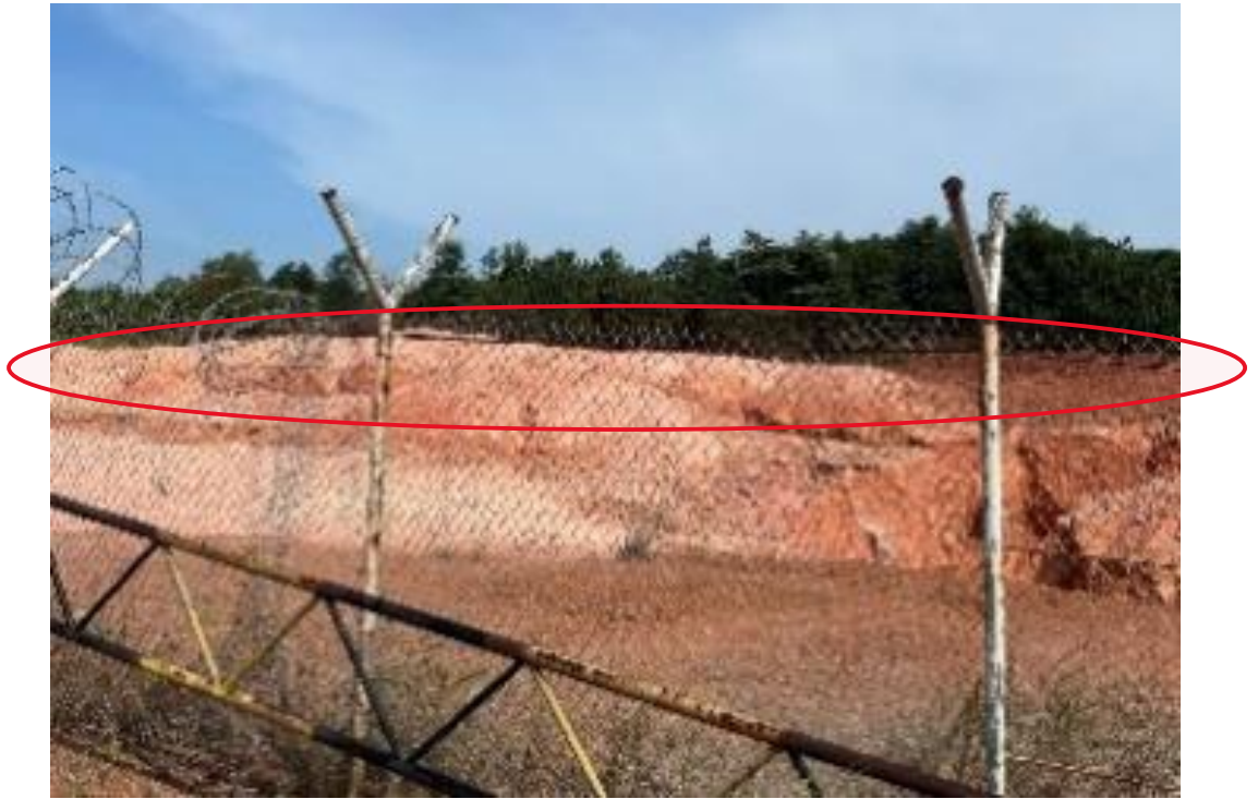
Gambar 4. 4 Pagar perimeter rusak
