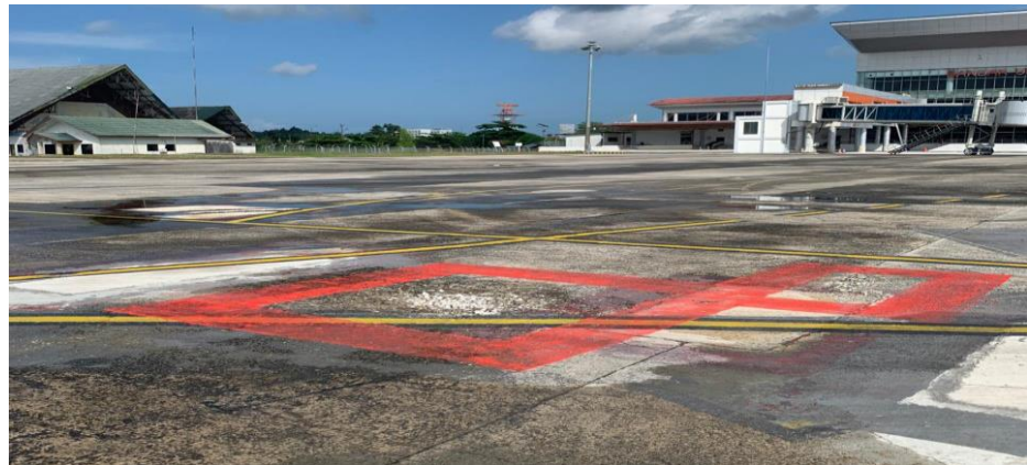
Gambar 4. 2 Kerusakan pada Permukaan Apron Sumber : Dokumentasi pribadi, 2024
