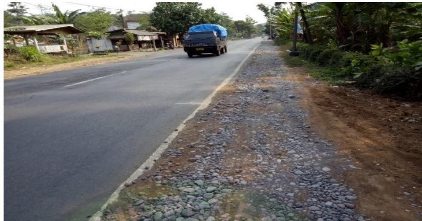
Gambar 3. 3 Bahu Jalan yang tidak diperkeras (sumber: https://www.wartapos.id diakses tanggal 10 Agustus 2023)
