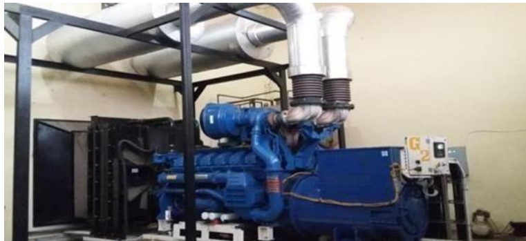
Gambar 2. 39 Genset dua 1250 kVA Sumber: Dokumentasi penulis
