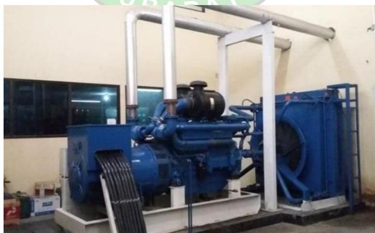
Gambar 2. 40 Genset 650 kVA Sumber: Dokumentasi penulis
