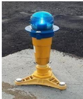
Gambar 2. 11 Taxiway Edge Light Sumber: Dokumentasi penulis
