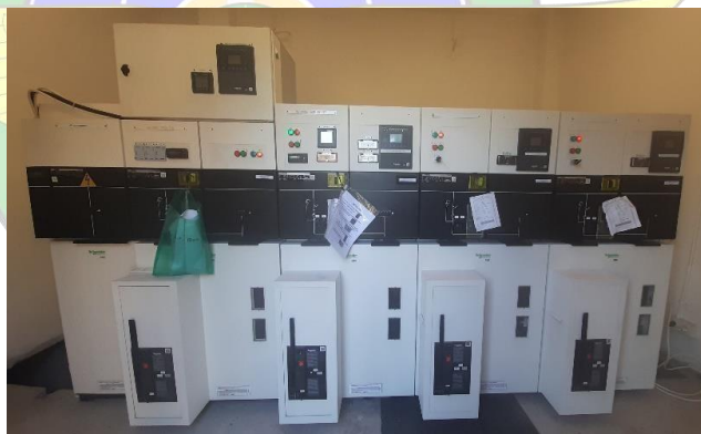
Gambar 2. 24 Cubicle TM Terminal baru Sumber: Dokumentasi penulis
