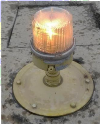
Gambar 2. 15 Runway Edge Light Sumber: Dokumentasi penulis
