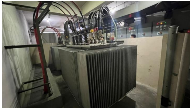
Gambar 2. 29 Trafo 1 Step Down Terminal Lama Sumber: Dokumentasi penulis
