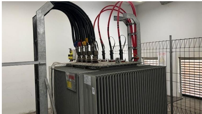
Gambar 2. 32 Trafo 2 Step Down Terminal Baru Sumber: Dokumentasi penulis
