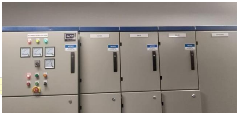
Gambar 2. 35 Panel LVMDP Terminal baru Sumber: Dokumentasi penulis
