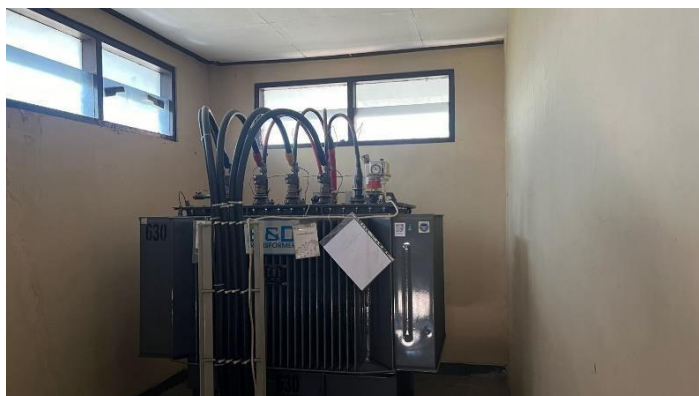
Gambar 2. 27 Transformator Redundant Sumber: Dokumentasi penulis
