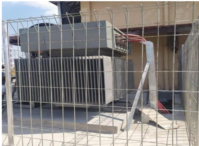
Gambar 2. 26 Transformator Step up Sumber: Dokumentasi penulis
