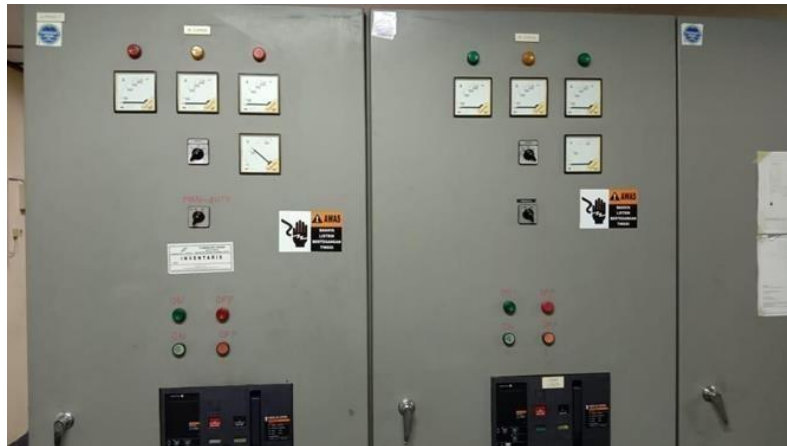
Gambar 2. 34 Panel LVMDP Terminal Lama Sumber: Dokumentasi penulis
