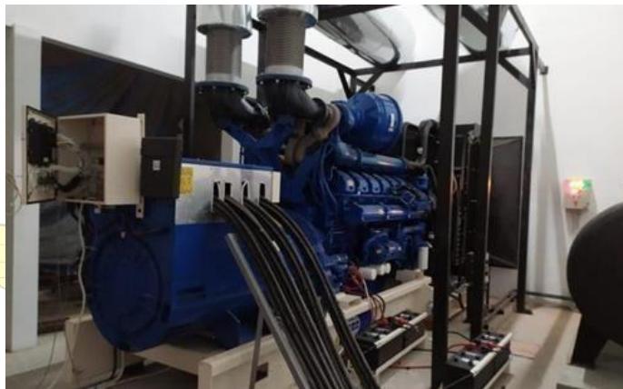
Gambar 2. 41 Genset 1500 kVA Sumber: Dokumentasi penulis
