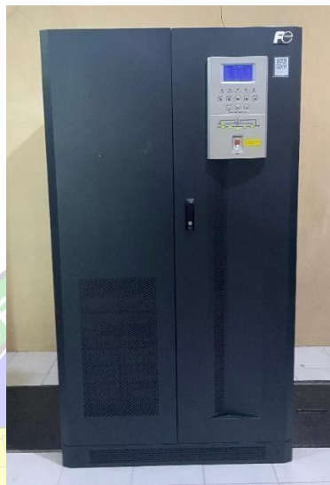
Gambar 2. 42 UPS AFL Sumber: Dokumentasi penulis
