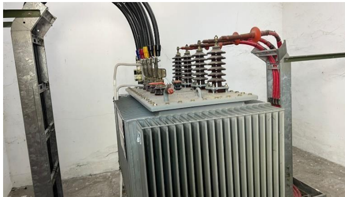
Gambar 2. 33 Trafo Step Down Stasiun Sumber: Dokumentasi penulis
