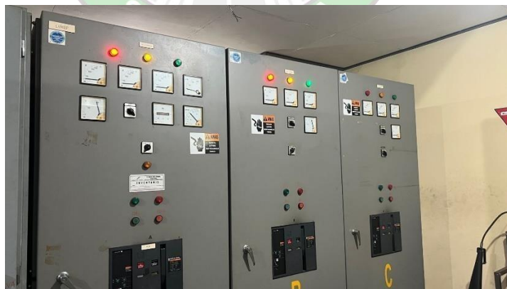
Gambar 2. 36 Panel LVMDP from MPH Sumber: Dokumentasi penulis
