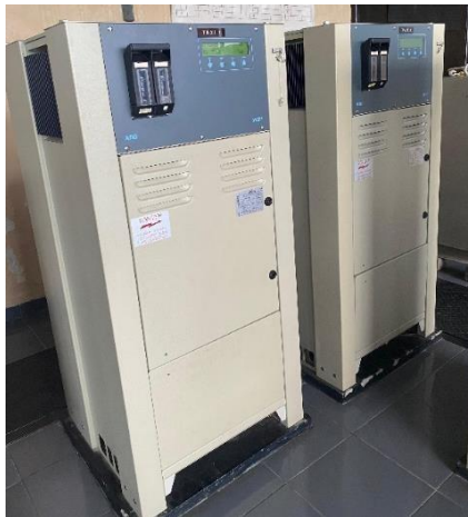
Gambar 2. 47 CCR Taxiway Light Sumber: Dokumentasi penulis
