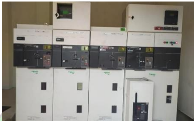
Gambar 2. 23 Cubicle TM Terminal Baru milik PLN Sumber: Dokumentasi penulis
