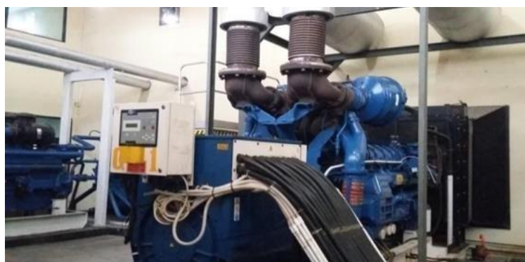
Gambar 2. 38 Genset satu 1250 kVA Sumber: Dokumentasi penulis
