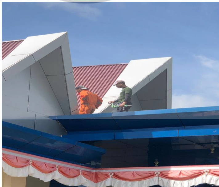
Gambar 4.14 Pencarian lubang di bagian atap Gedung Administrasi UPBU Sugimnauru
